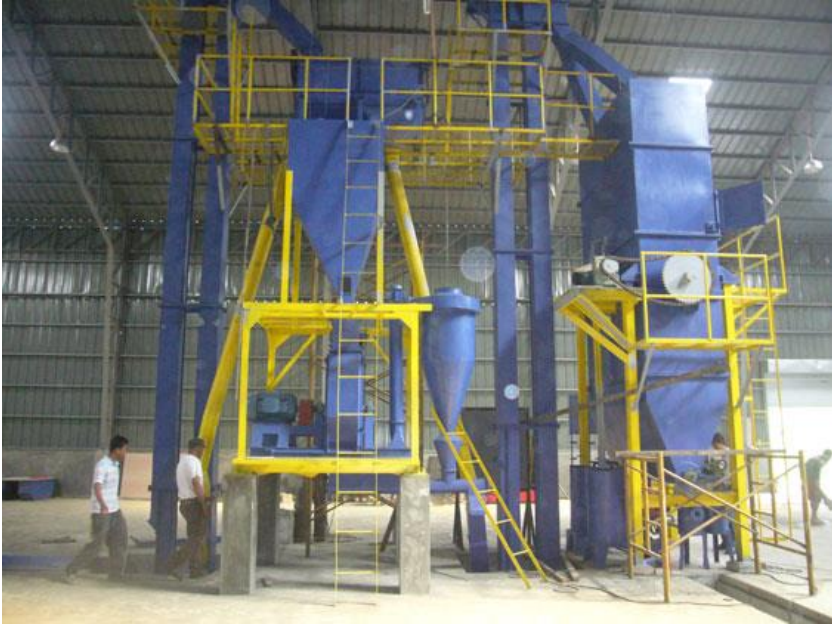
Gambar 14. Penempatan Mixer Vertical di Pabrik Pakan
