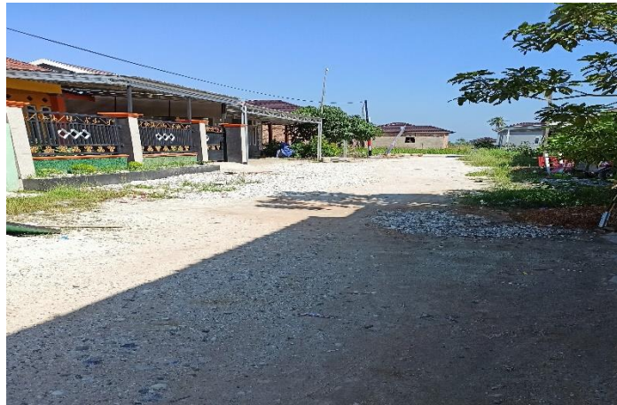
Gambar 7 Jalan Perumahan Belum Ada Saluran Drainase ( Sumber :Dokumenasi Pribadi , 2021 )
