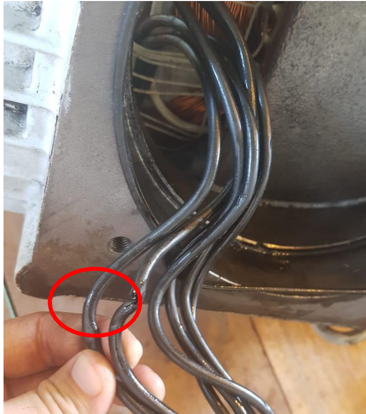
Kabel winding yang putus dan rusak
